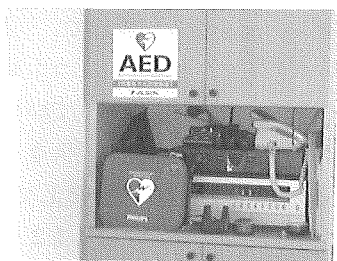
AED設置場所(フロント内)
